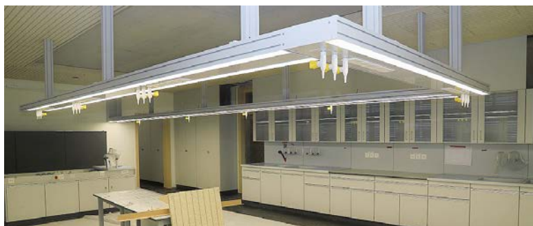
Der an der Decke befestigte Medienbalken in den beiden Chemie- / Physikzimmern ermöglicht ein flexibles Arbeiten mit Gas und Elektrogeräten.
