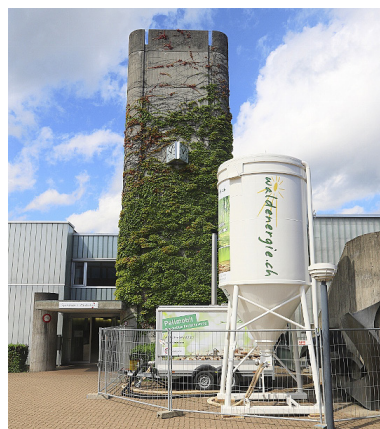
Bis zur Inbetriebnahme der Pelletheizung bleibt die provisorische Anlage vor dem Spezialtrakt in Betrieb.
