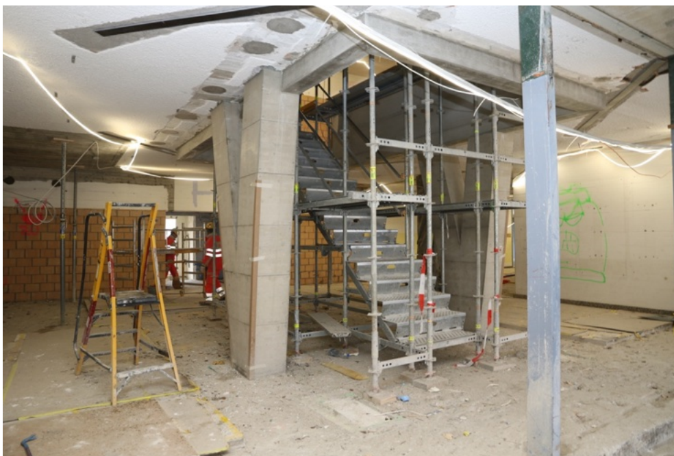
Die V-Stützen für die neue Haupttreppe stehen bereits, die definitiven Treppenelemente werden bald eingebaut.
