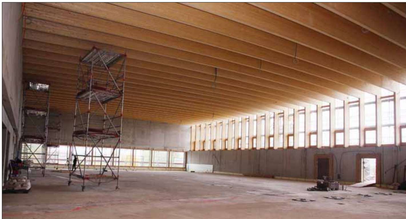
Die grossen Dachträger aus Holz spannen sich über die gesamte Breite der neuen Doppelturnhalle im zweiten Geschoss.
