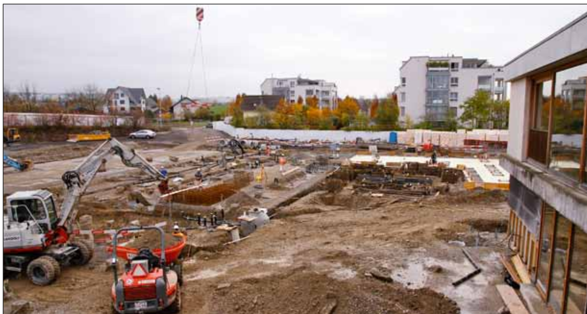
Nach der Pfählung wurde anfangs November im vorderen Teil des Schulhausbaus bereits die Wärmedämmung angebracht (rechts im Bild). Auf diese wird dann die Bodenplatte gegossen.
